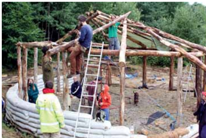
Slika: Izgradnja kuće od slame s drvenom konstrukcijom i temeljima od vreća punjenih zemljom. Ekoselo Blatuša.
